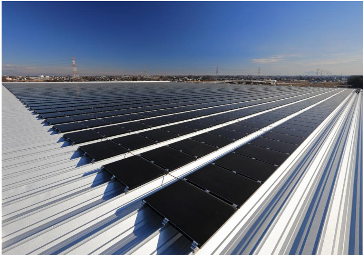
○屋上太陽光発電設備
